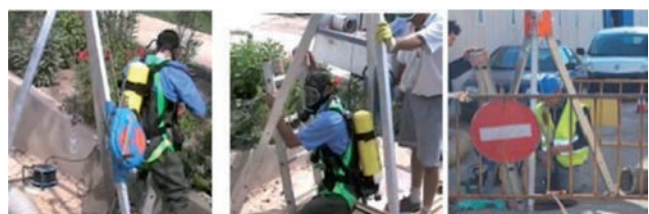
Fig. 7: Bajadas a EECC mediante escalera manual
