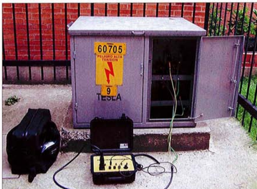
Conexión de UC al transformador de MT/BT.
