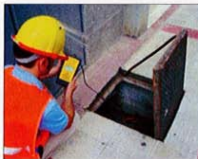
Identificación de cables en arqueta
