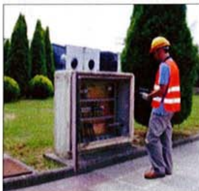
Conexión de UL a CGP.
