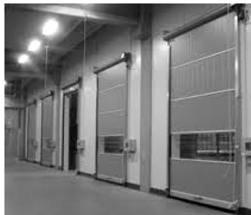
Fig. 6: Puertas automáticas en cámaras frigoríficas
