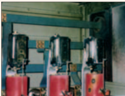
Fig. 15. Por descuido, el operario intentaba reenganchar a mano la protección bajo una tensión de 16 kV
