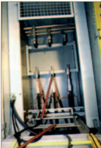
Fig. 11. Celda con protección de puerta a tierra y conexión a tierra bloqueada
