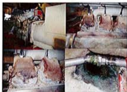
Fig.2. Efectos del azufre: unidades de generación dañadas Fuente: autor
