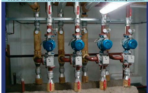
Foto 1: Instalación con cuatro circuitos de calefacción con regulación independientes.
