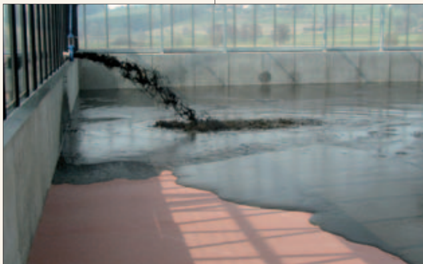
Entrada de fango decantado en nave-invernadero con suelo filtrante
