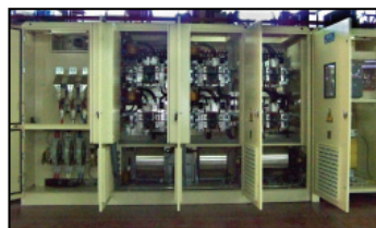
Fig. 18: Armario de regulación de velocidad para molino de bolas de 6,5 MW con IGCT. Cortesía de International Electronics, Alcorcón, Madrid.
