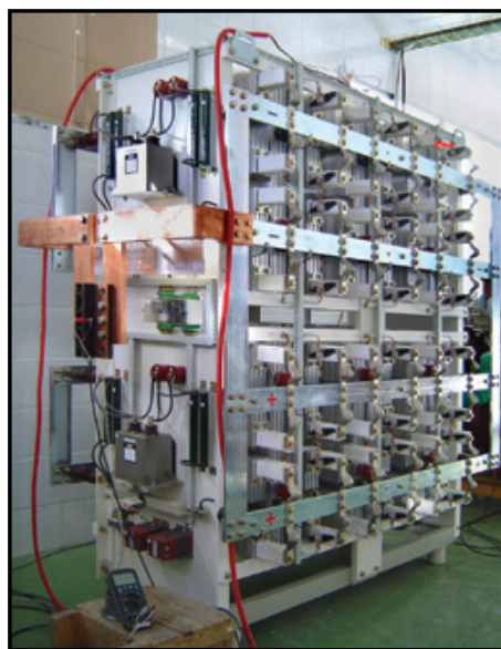
Fig. 20: Rectificador trifásico de 6 MW para catenaria de ferrocarril de 3000 V con 96 diodos en doble puente y 8 diodos en paralelo por célula. Cortesía de ADIF y CUADRELEC, Madrid.
