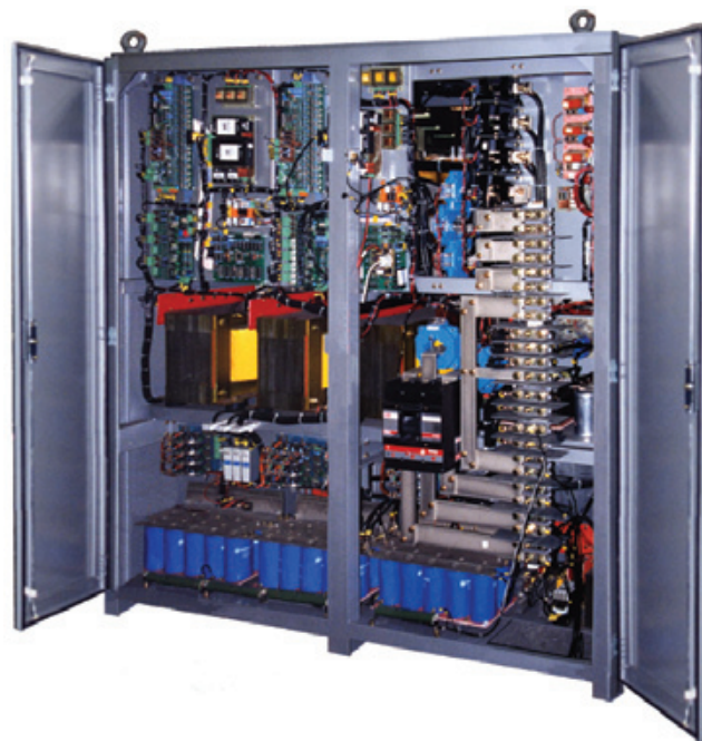
Fig. 14: Controlador unificado de flujo de potencia (UPFC), o acondicionador universal, con filtros activos serie (para tensión) y paralelo (para corriente) de 400 kVA. Primer UPFC reconvertible a SAI [16] [18] en caso de fallo total de la tensión de red mediante la reconfiguración de su topología sin recurrir a interruptores estáticos de entrada y de salida. Cortesía de IBERDROLA, proyecto ACCIONE.
