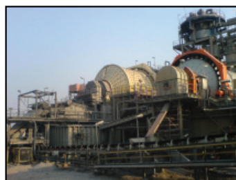
Fig. 17: Instalación de molinos SAG (Semi Autogenous Grinding) de 12 MW (izquierda) y de bolas de 6 MW (derecha) para minería accionados por motores de rotor bobinado en Kansanshi Mine, Zambia. Cortesía de International Electronics, Alcorcón, Madrid.
