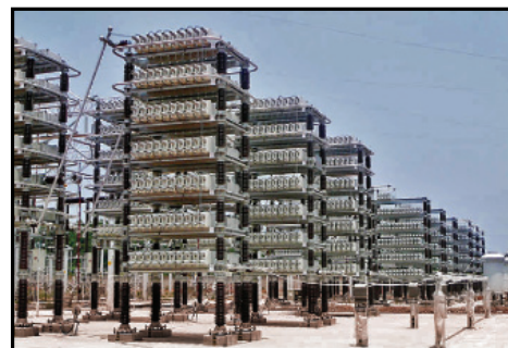
Fig. 10: Convertidor electrónico c.a./c.c. reversible de un sistema de transmisión de energía eléctrica de alta tensión. Cortesía de ABB .
