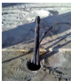
Fig. 1: Extremos de la tubería en U introducida en la sonda
