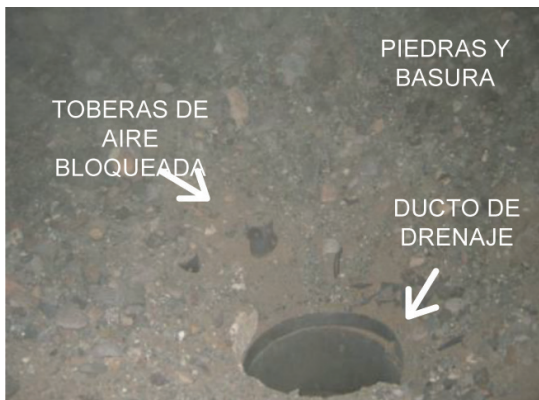
Fig. 8: Conducto de drenaje y toberas de aire bloqueadas por material de alta densidad
