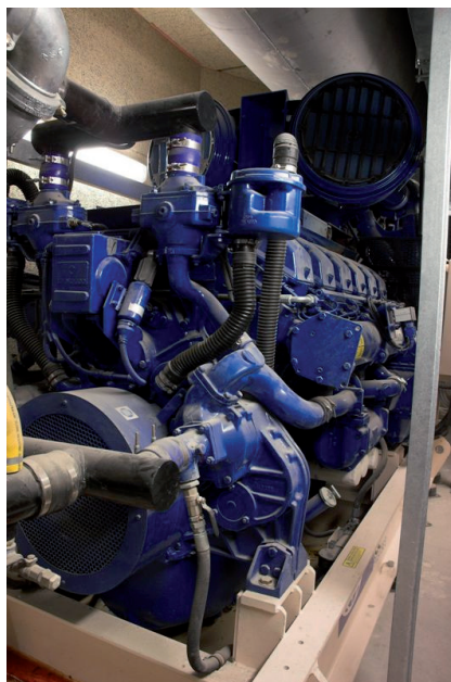
Grupo electrógeno. Imagen propiedad de Torre Iberdrola AIE
