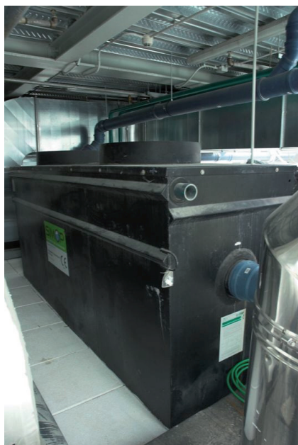
Equipamiento de separación y recuperación de hidrocarburos. Imagen propiedad de Torre Iberdrola AIE
