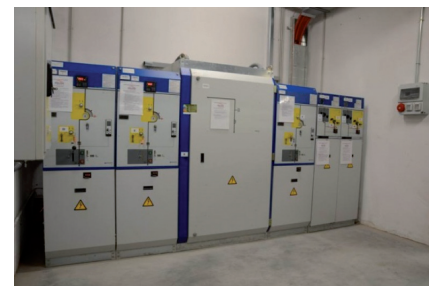
Celdas de MT. Imagen propiedad de Torre Iberdrola AIE
