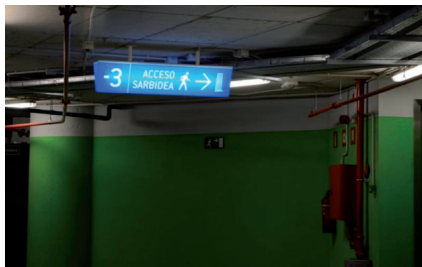
Señalética de evacuación. Imagen propiedad de Torre Iberdrola AIE
