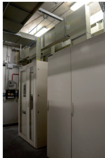
Detalle de canalización prefabricada. Imagen propiedad de Torre Iberdrola AIE
