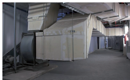
Sistema de presurización de vías de evacuación. Imagen propiedad de Torre Iberdrola AIE
