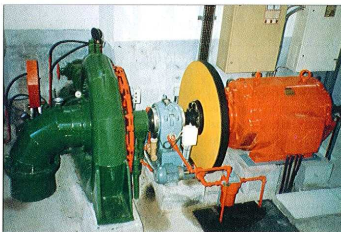
Central hidroeléctrica de Batán (Coruña)
