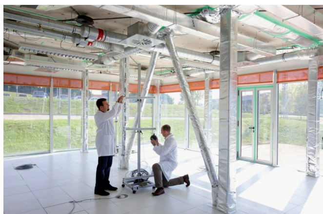
Fig. 1: Instalación de sensores en el edificio experimental para el análisis de la eficiencia energética
