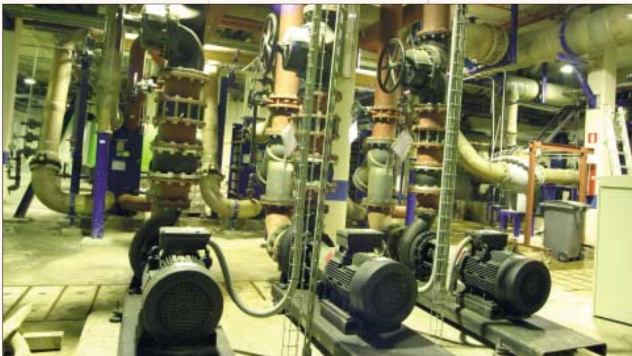
Detalle de la instalación de climatización, con una potencia frigorífica instalada de 6.800.000 frig/h
