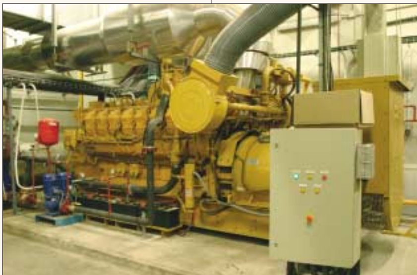
La planta de cogeneración consta de tres motores de 1 MW cada uno, funcionando a gas natural
