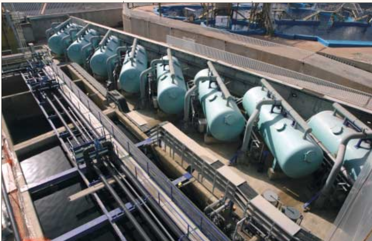
El sistema de filtración del Delfinario consta de ocho filtros de arena, de nueve metros de longitud por tres metros de diámetro cada uno
